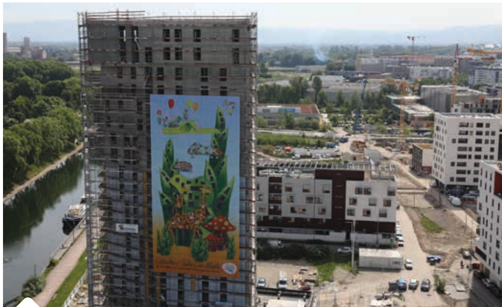
La tour Elithis Danube compte 4500 m 2 de logements mais aussi 800 m 2 de bureaux, en pied d'immeuble. - PHOTO JÉRÔME DORKEL
