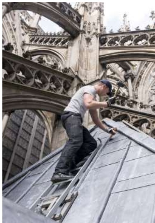
Couvreurs sur la toiture de la cathédrale de Cologne, 2017, Crédit Hohe Domkirche Köln, daumbauhütte Köln
