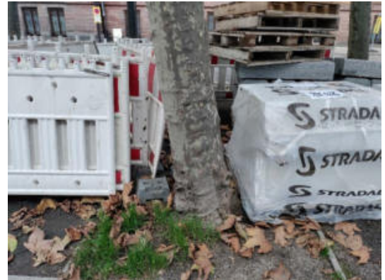
Photo 7 : Stockage de matériel de chantier au pied de l'arbre = asphyxie du système racinaire + risques de chocs au tronc
