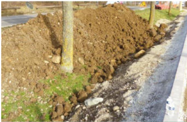
Photo 6 : Stockage de matériaux au pied de l'arbre = asphyxie du système racinaire
